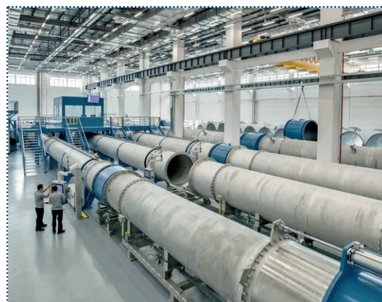
Rys. 2. Akredytowana stacja kalibracyjna Endress+Hauser Flow
