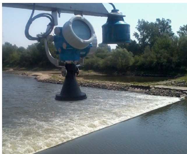
Sonda radarowa Micropilot na ujęciu wody rzecznej do stacji uzdatniania
