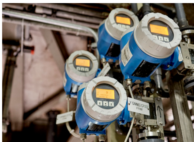
Przepływomierz Promass na rurociągu zasilającym segmenty palników
