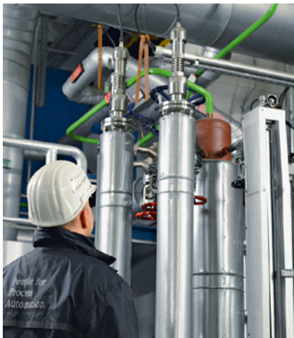
Pomiar poziomu wody w wymienniku regeneracyjnym NP za pomocą sondy z falowodem. Pomiar w systemie „2 z 3”
