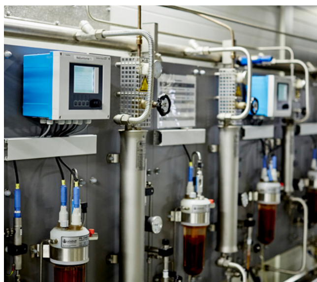
Panelowe systemy poboru i analizy próbki pary i wody z układami do pomiaru pH, przewodności, tlenu i SiO 2
