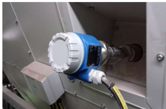
Sygnalizator Soliphant M w leju zasypowym elektrofiltra
