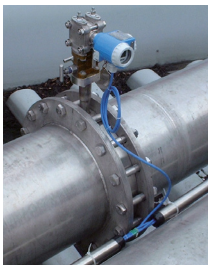
Przetwornik różnicy ciśnień Deltabar ze zwężką pomiarową na rurociągu wody uzdatnionej
