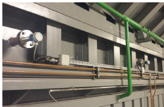
Soliwave w leju zasypowym filtra
