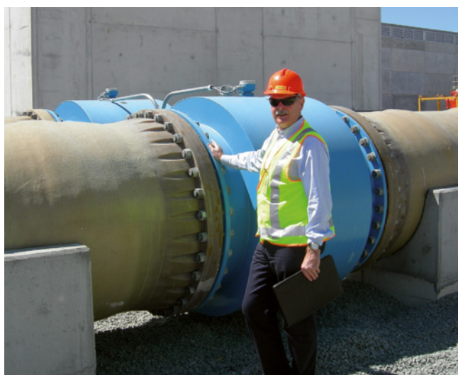
Przepływomierz Promag na rurociągach zasilania stacji uzdatniania wody
