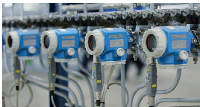
Przetworniki ciśnienia i różnicy ciśnień w elektrowni, podłączone elektrycznie za pomocą uniwersalnego złącza Harting plug Han®7 D
