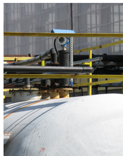
Radarowa sonda poziomu Micropilot w zbiorniku magazynowym kwasu solnego
