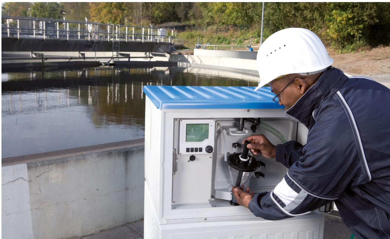
Wymiana wszystkich elementów eksploatacyjnych w stacji bez użycia narzędzi.
