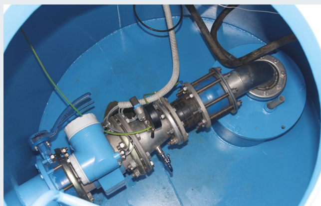
Przepływomierz Promag 10L w obudowie studni głębinowej.
