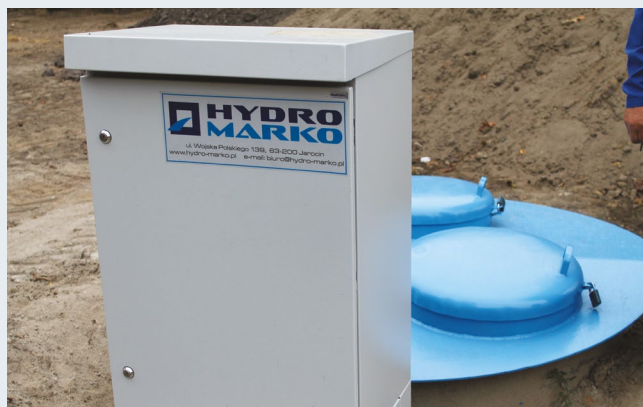
SUW „Szczekanica” – wyposażenie studni głębinowej.
