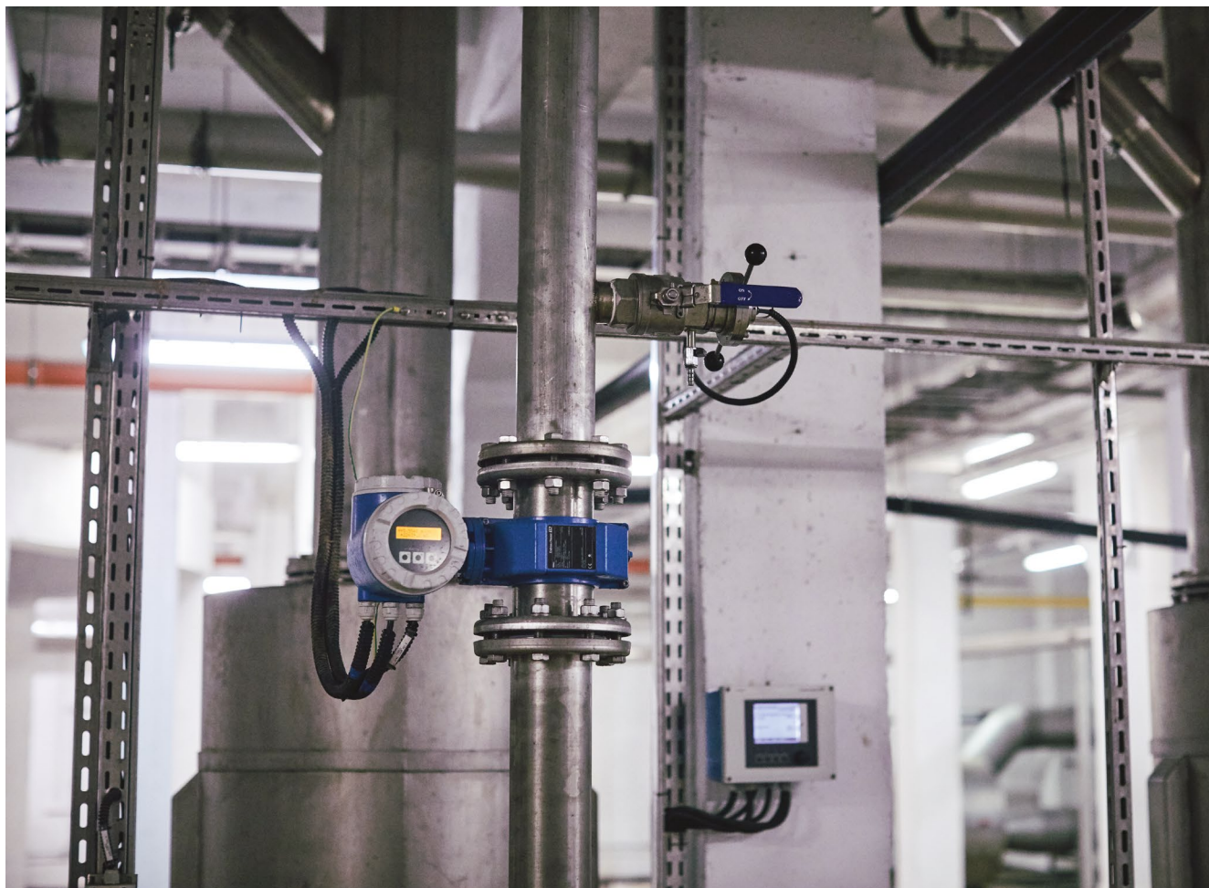
Pomiar przepływu oraz gęstości osadu przed wirówką odwadniającą.
