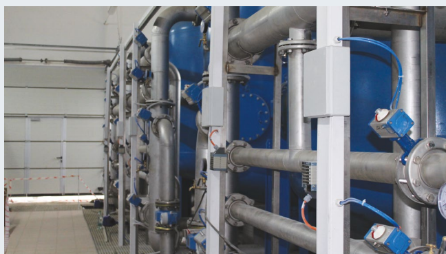
SUW „Szczekanica” – urządzenia pomiarowe w hali filtrów i pompowni wody.
