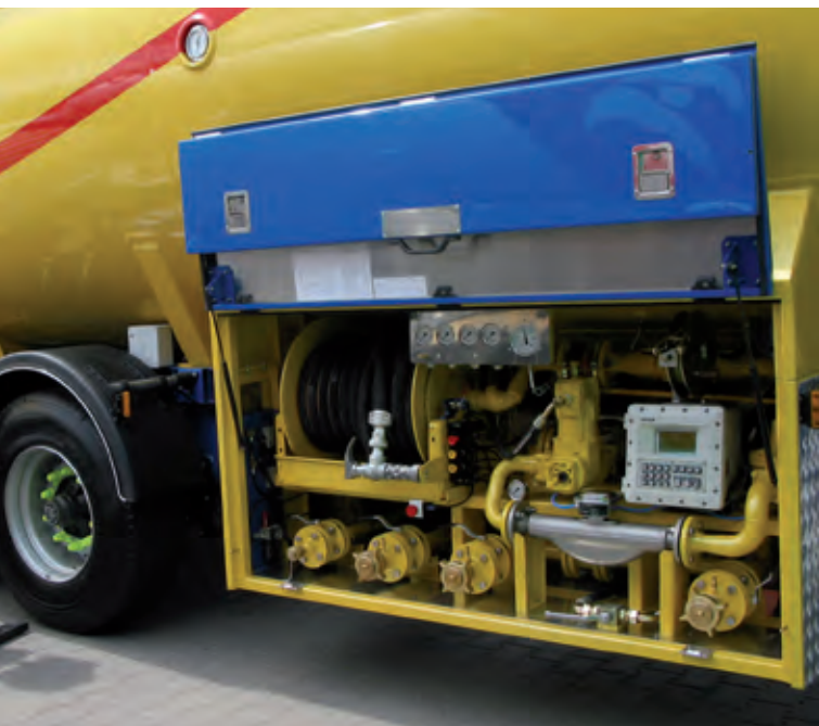
Układ pomiarowy wydawania LPG z przepływomierzem Promass 84F i licznikiem przepływu, zainstalowany na cysternie drogowej
