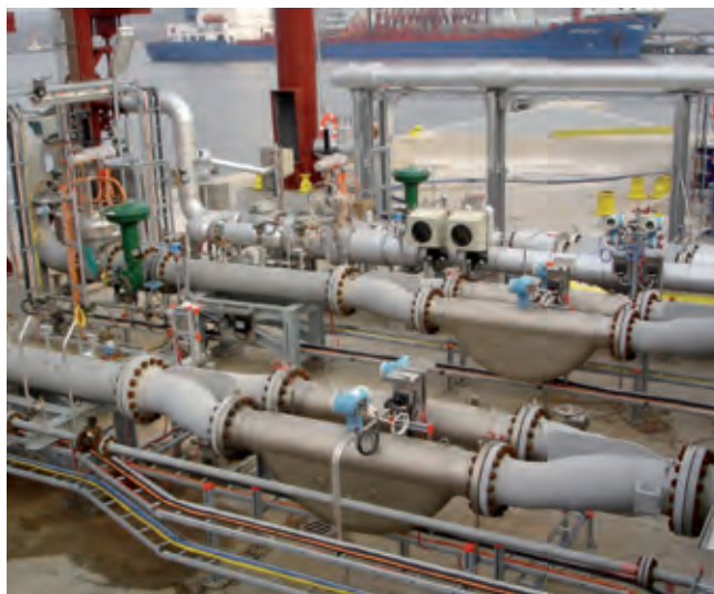
Instalacja pary przepływomierzy Promass (tzw. tandemu) na platformie przeładunkowej
