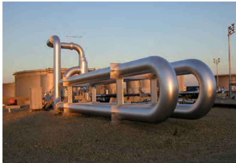
System kalibracji na instalacji ropociągu SPSE (Société du Pipeline Sud Européen) do wzorcowania przepływomierzy masowych Promass za pomocą mediów naftowych
