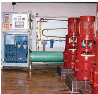
Automatyczna rejestracja czasu pracy pomp za pomocą rejestratora Minilog B.
