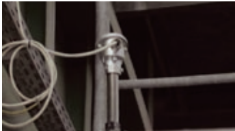
Pomiar wysokich temperatur w piecu wapienniczym: przetwornik główkowy zamontowany na zewnątrz.
