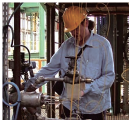
Konserwacja zainstalowanej komory bezpieczeństwa
