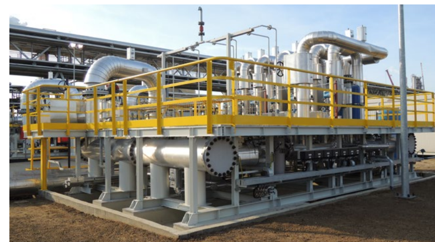
Skid pomiarowy Endress+Hauser do rozliczeń ropy naftowej Q max =1500 m 3 /h
