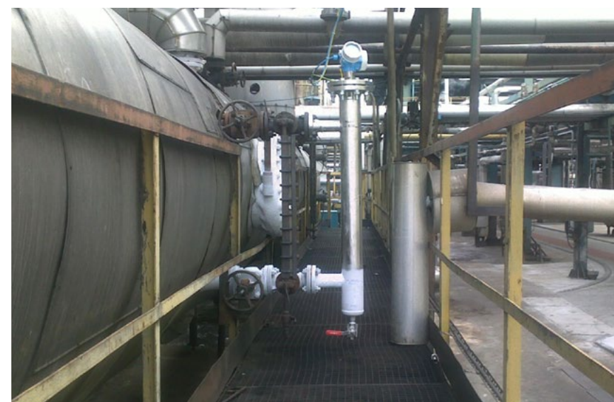
Naczynie poziomowskazowe z radarem Levelflex po modernizacji
