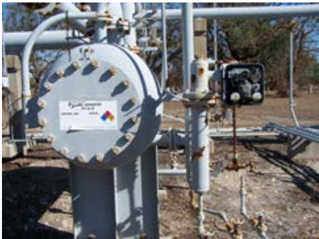
Uszkodzony, nurnikowy pomiar poziomu w separatorze woda/węglowodory
